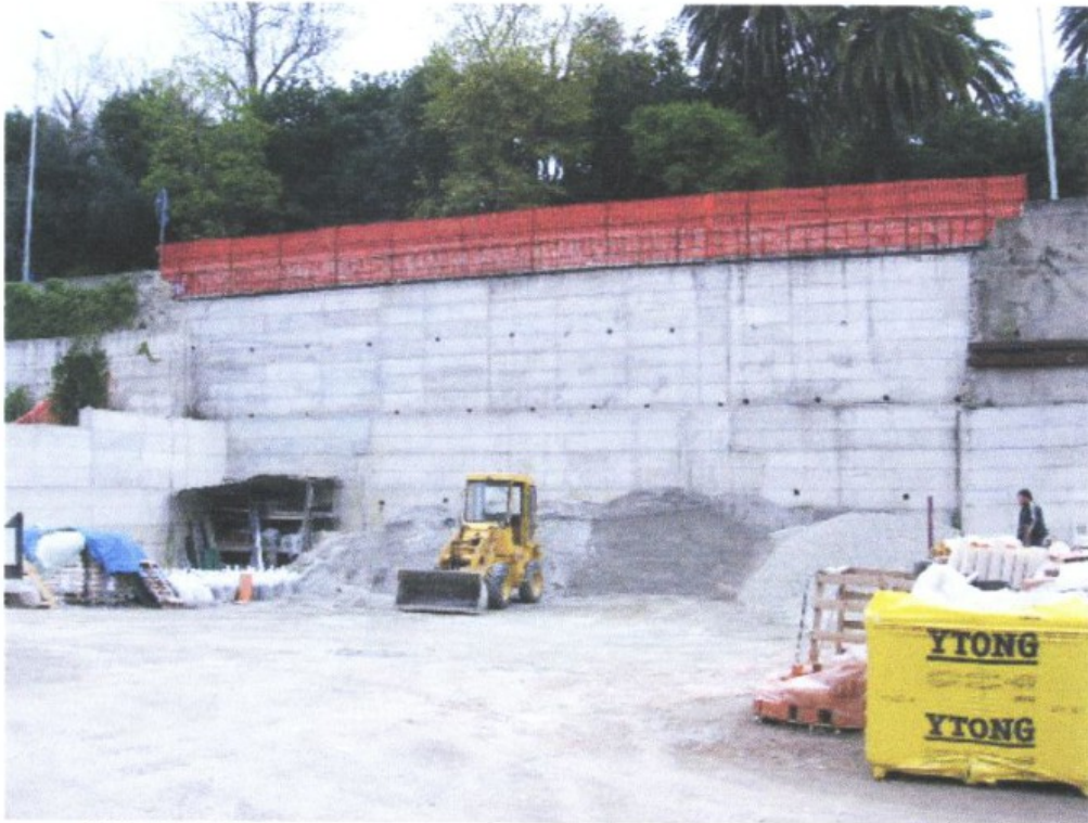
COSTRUZIONE MURO DI SOSTEGNO VIA STURLA PROSPICIENTE LA PROPRIETA' ED ESEGUITA DAL COMUNE DI GENOVA
