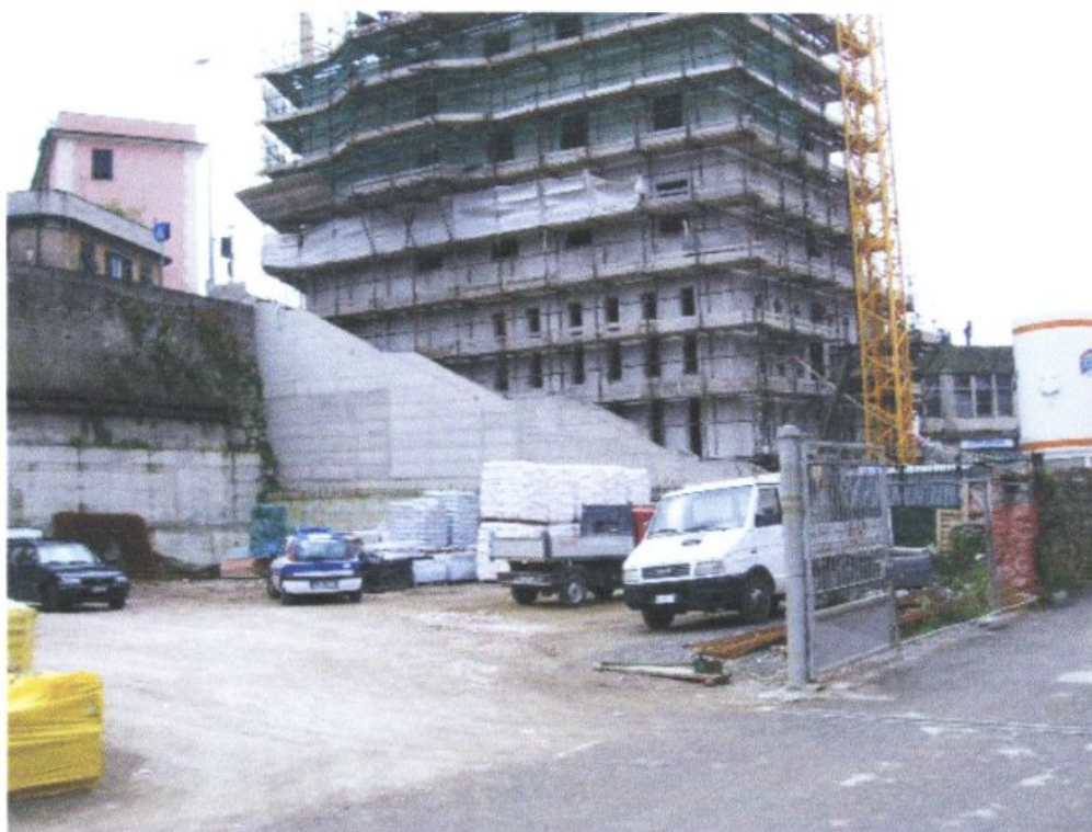
OPERA DI COSTRUZIONE MURO DI SOSTEGNO SCALA COMUNALE ESEGUITA DALLA DITTA "EDILALBARO SRL"
