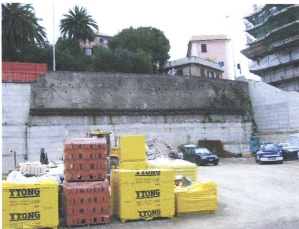
OPERA DI CONSOLIDAMENTO MURO DI SOSTEGNO VIA STURLA ESEGUITA DALLA DITTA "EDILALBARO SRL"
